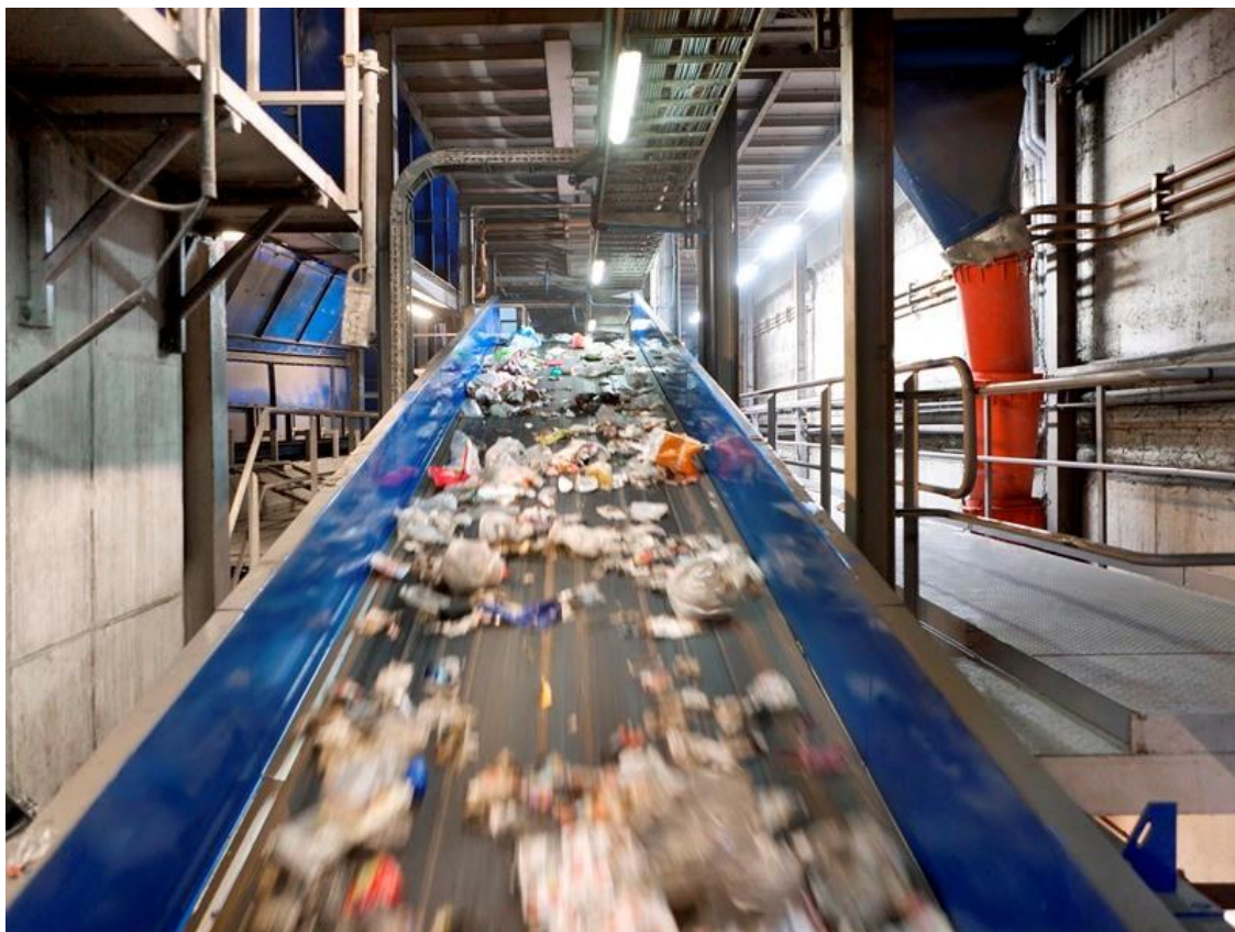
Lopende band in de scheidingsinstallatie van Omrin.
